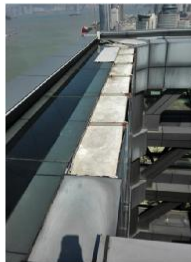
屋顶压板受损严重
