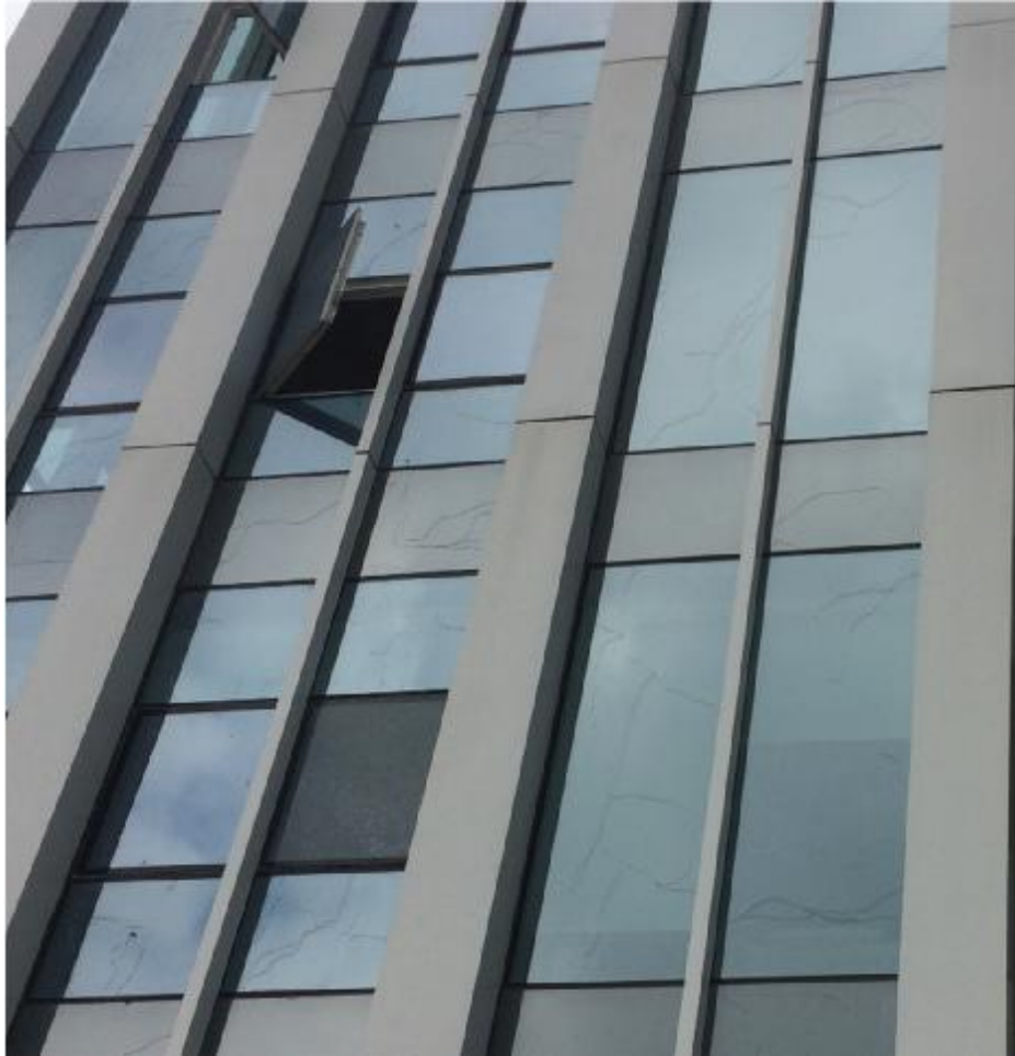
裙楼玻璃面板较多裂纹
